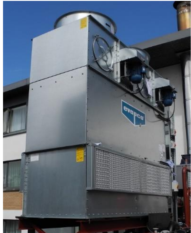
Figura 7) – Torre evaporativa assiale controcorrente Evapco di potenza nominale pari a 255,6 kW, deputata allo smaltimento del calore generato dall'assorbitore in esame.
